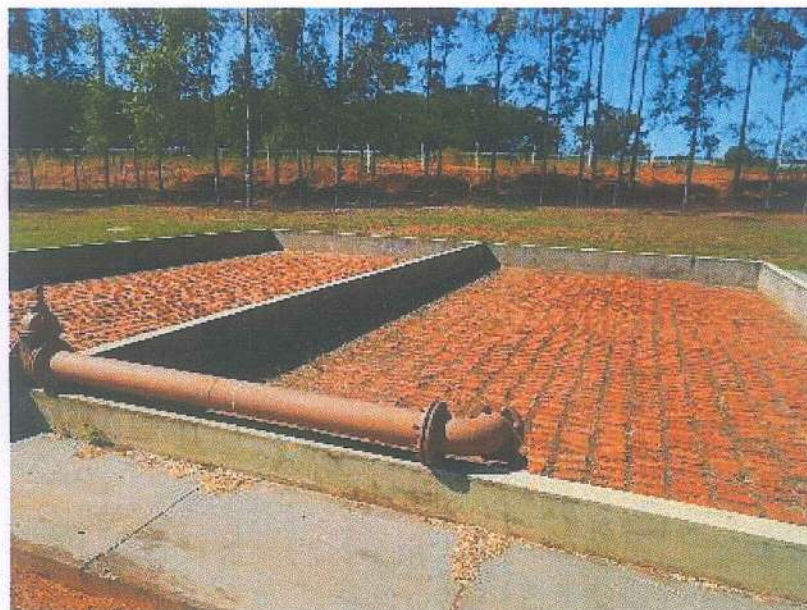
Figura 24 – Leito de secagem do lodo da ETE
