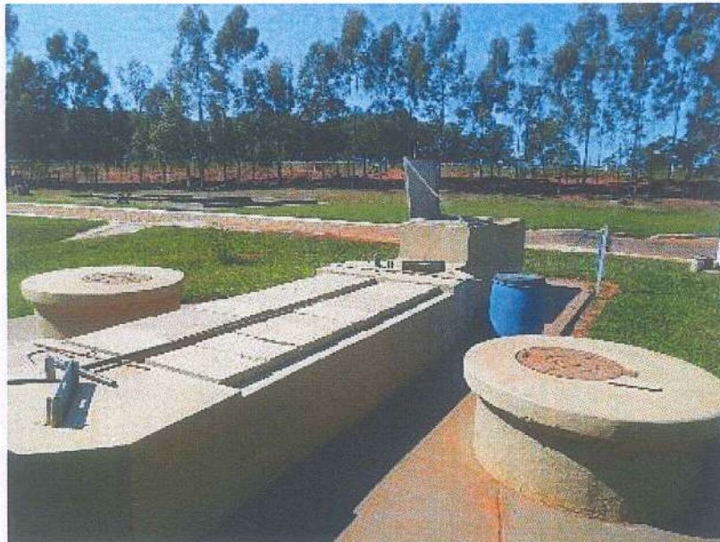
Figura 23 – Sistema de pré tratamento da ETE
